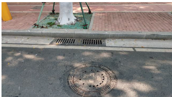
兴发路雨水井
