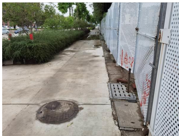
木河迳东路市政雨水井、集水口
