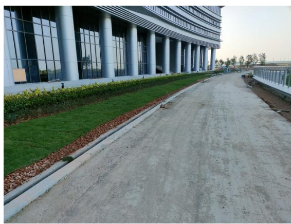
道路硬化情况
