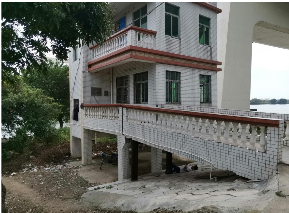
水闸管理房连接桥沉降缝
