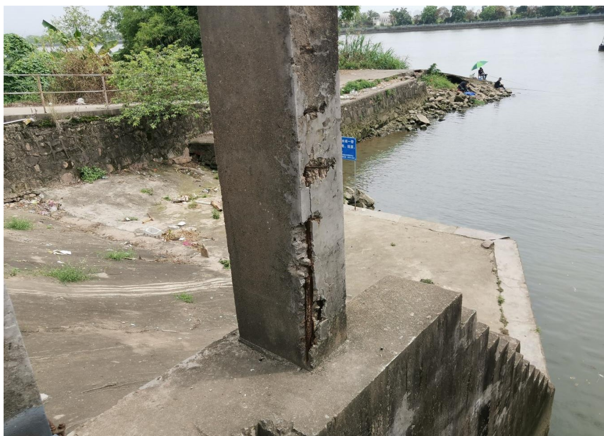
水闸启闭柱爆筋
