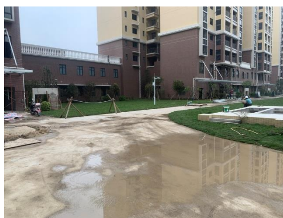
道路硬化情况
