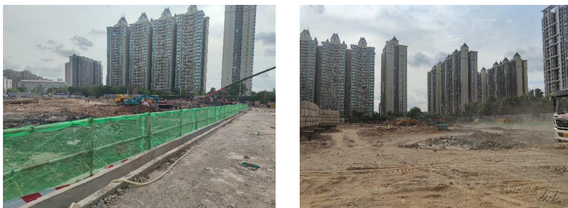
图 4-1 建设场地水土流失调查图
