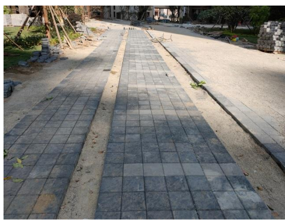
道路硬化情况
